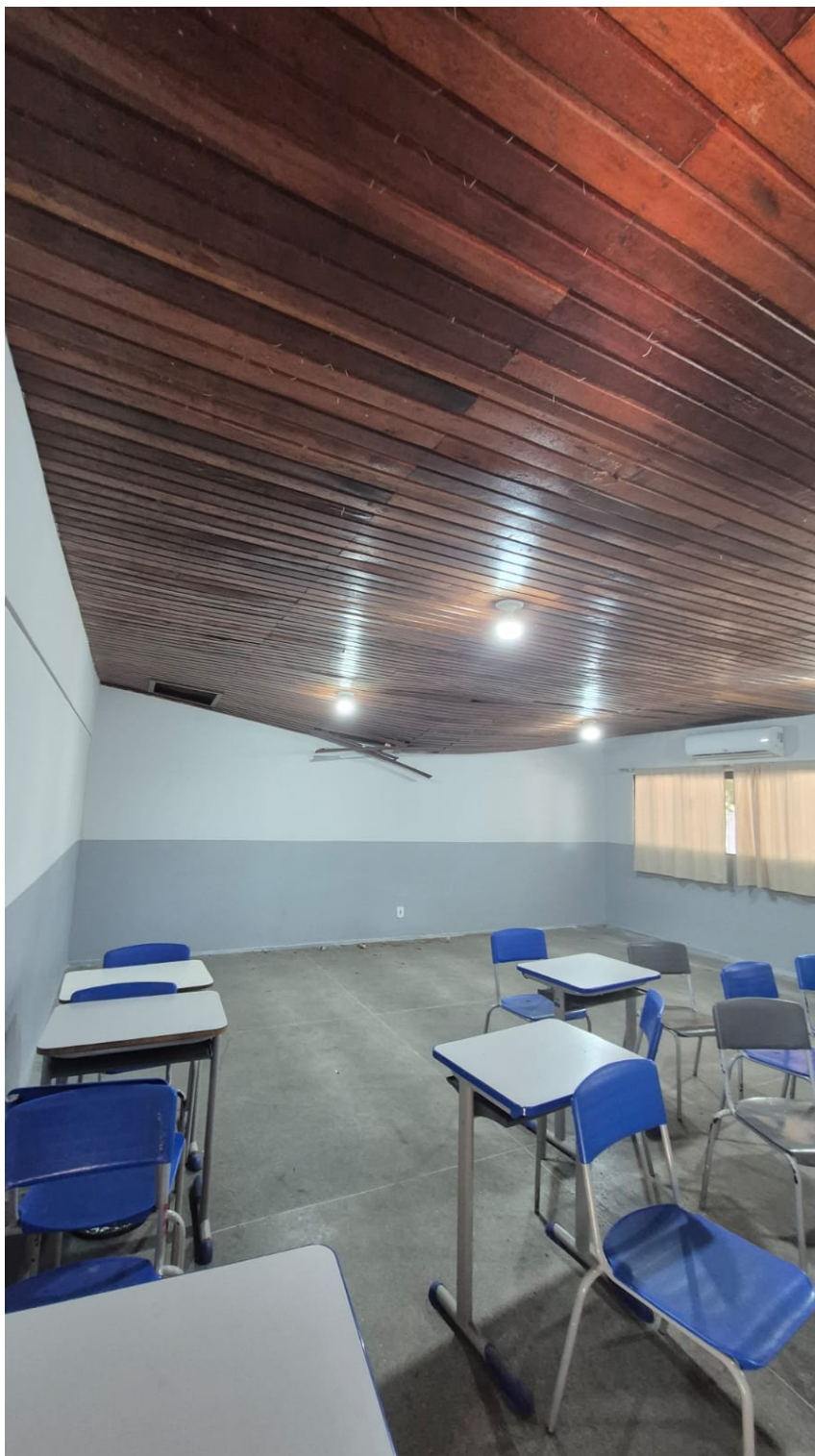
Foto 4 – Vista do forro de madeira com sinais de deterioração e desgaste do material.
