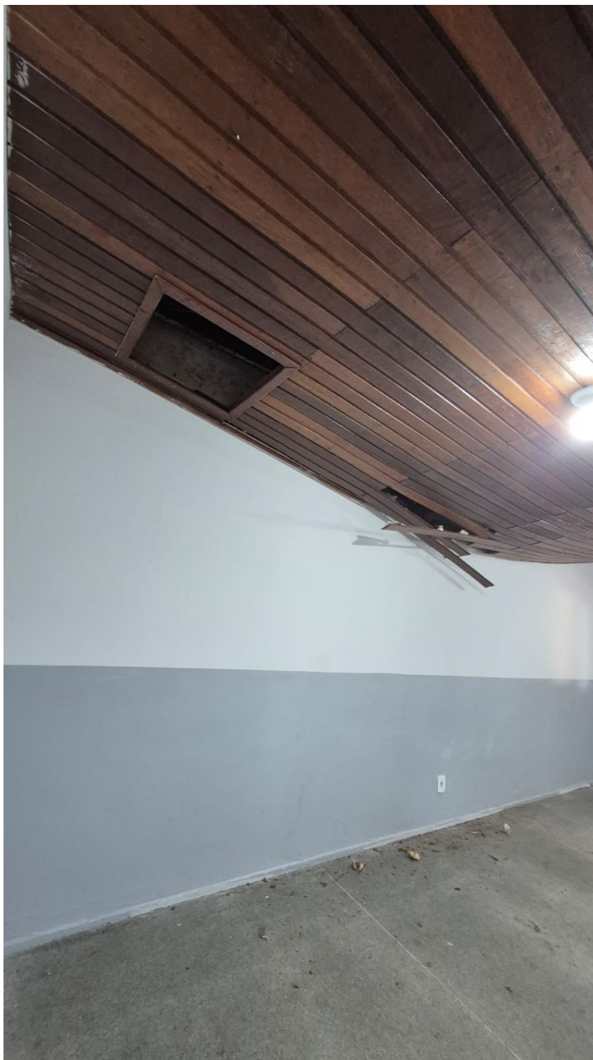
Foto 3 – Detalhe do ponto de desprendimento do forro, próximo ao alçapão de acesso.
