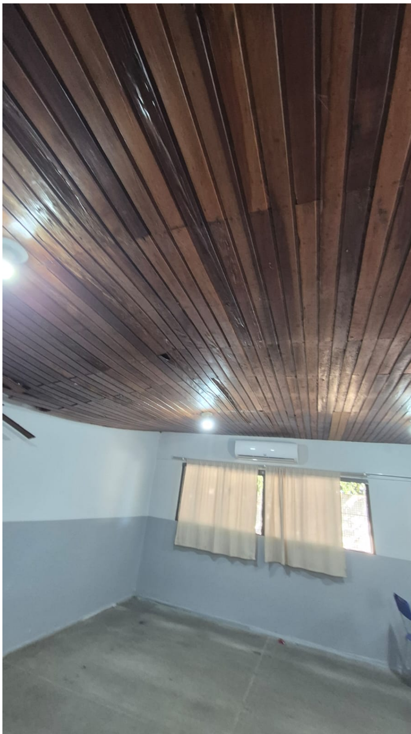
Foto 1 – Forro de madeira solto/desprendido, com peças caídas e estrutura visivelmente comprometida.
