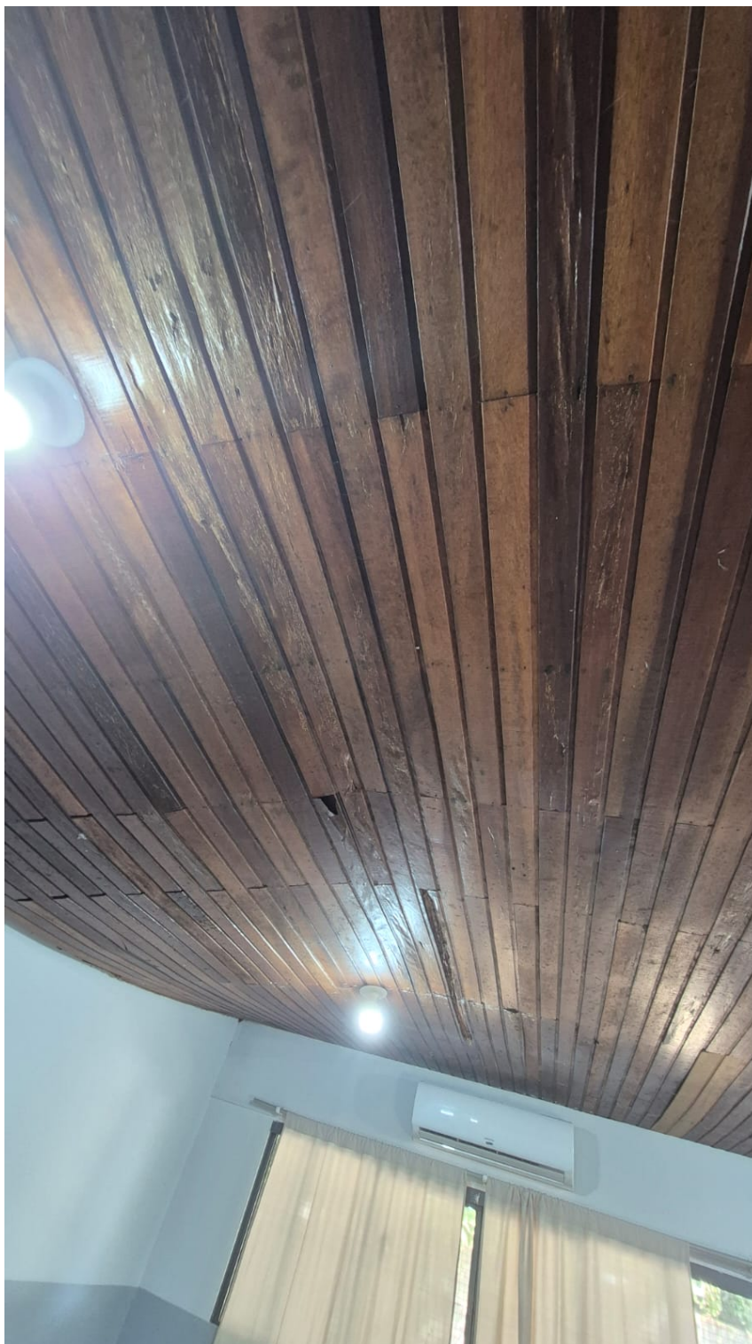
Foto 2 – Sala de aula: vista geral do forro danificado sobre o mobiliário escolar.
