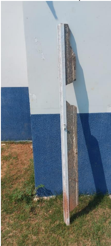
Foto do mármore quebrado
