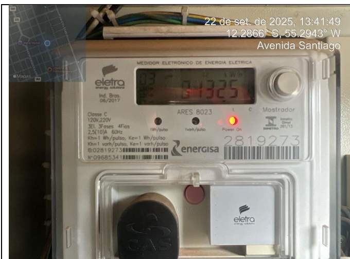
Medidor de Energia
