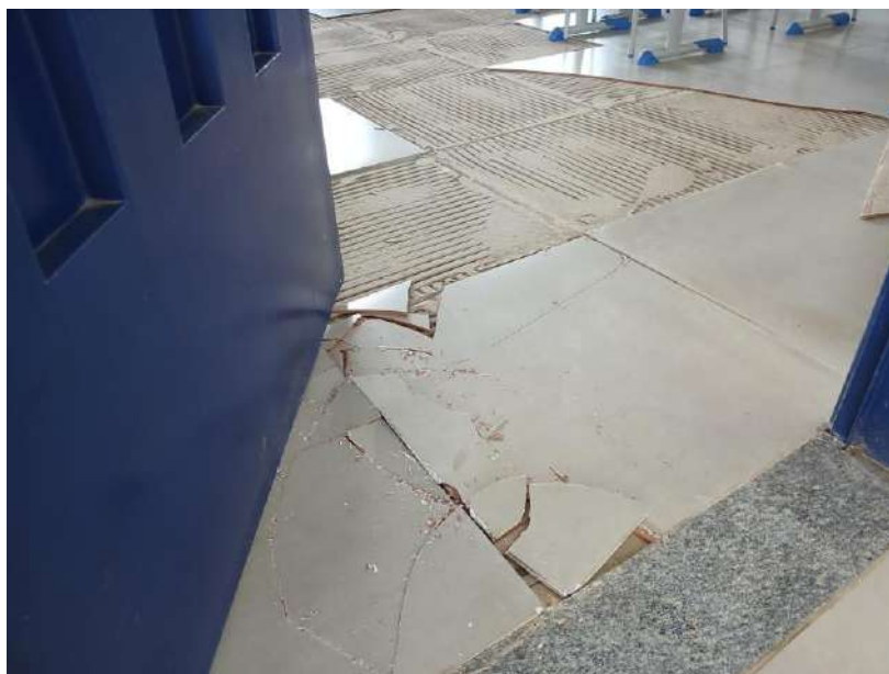
Sala APA – piso superior.
