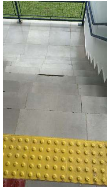
Escada esquerda na mesma situação.
