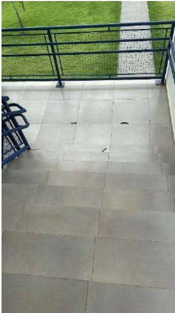
Escada direita com pisos soltos e trincados.
