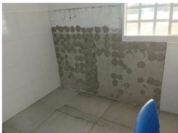
Parede da sala 14 – piso superior.
