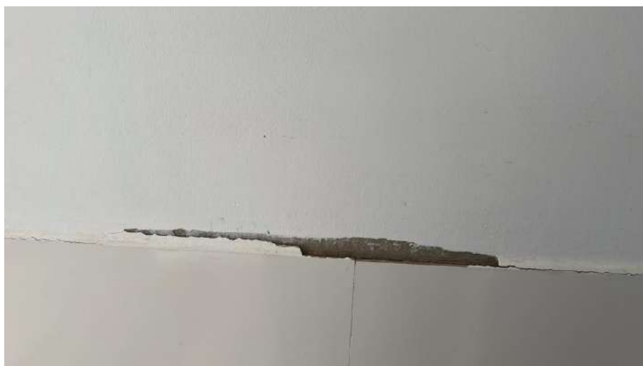
Parede direita da porta de entrada do banheiro feminino – piso superior.
