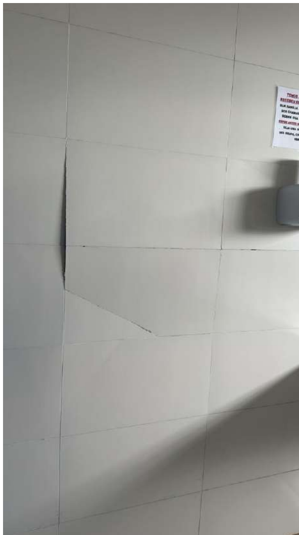
Parede banheiro feminino – piso superior.
